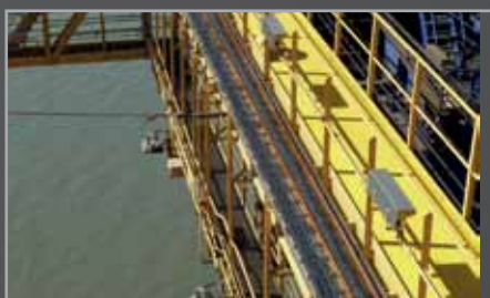
Kabeltrassen Cable tray
